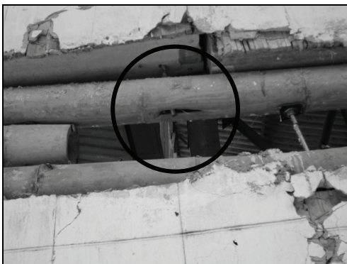
Figura 25. Desgarramiento de la viga inferior
