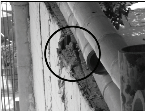
Figura 24. Falla en la solera
