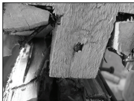
Figura 22. Falla en la unión del panel
