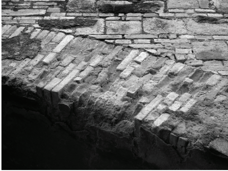
Figura 2. Vista inferior de la rosca de uno de los arcos del puente sobre el río Cauca, en Popayán, en la que se aprecia el grado diferencial de deterioro de los ladrillos constitutivos. Foto: J. C. Muñoz (2007)
