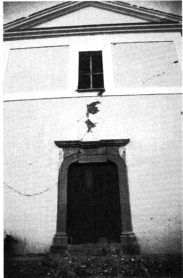
Figura 4 – Viggianello (VI MCS), chiesa di S. Francesco. L'edificio, appena terminato di restaurare, presenta profonde lesioni nell'abside e nella facciata. Si notano un meccanismo di rottura locale dell'architrave ed una lesione a taglio che interessa l'intera facciata.
