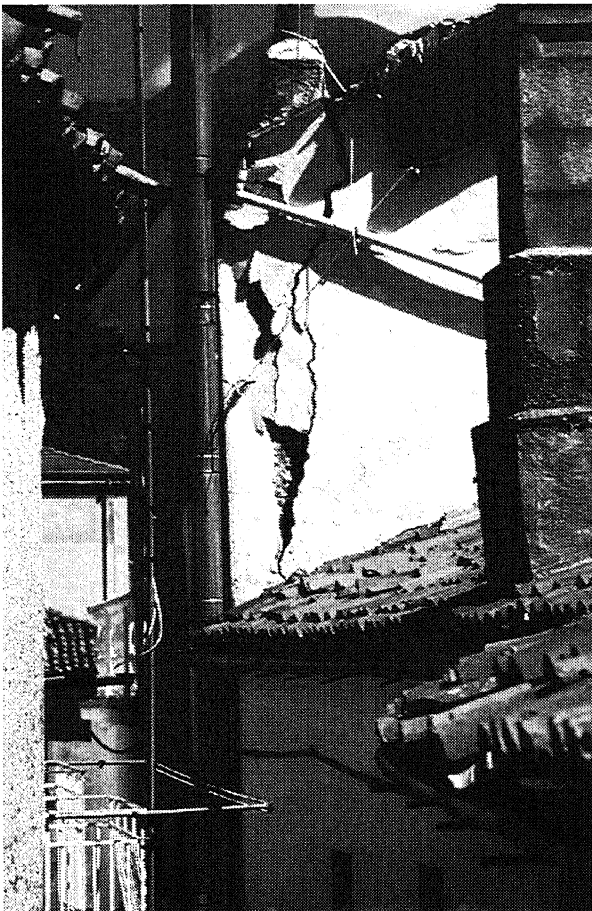
Figura 3 – Perricchio (VII MCS). Ribaltamento di facciata in edificio in muratura mancante di collegamenti.
