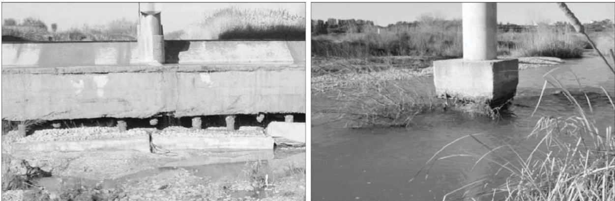
Fig. 10 - Effetti dei processi di erosione ed incisione nell'ultimo tratto del F. Sinni. A sinistra si vede lo scalzamento al piede della traversa di S. Laura, mentre a destra l'incisione è evidenziata dalle condizioni critiche del pilone di un ponte.
